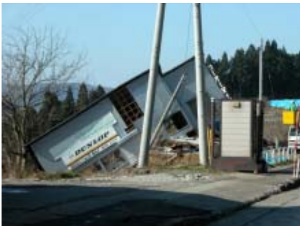
新潟県中越地震により崩壊した家
