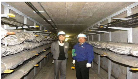
図1 とう道見学（地下ケーブル道）
