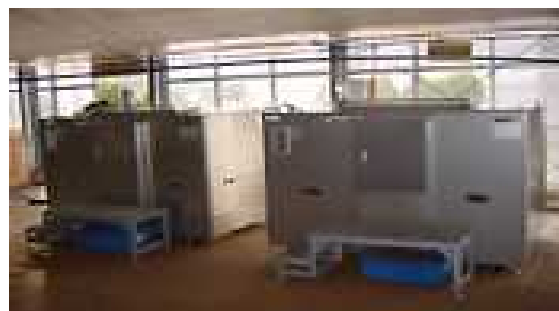
図2 倉賀野ビル見学（残渣処理）
